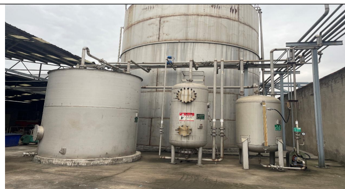
蒸汽冷凝水回收处理设备
