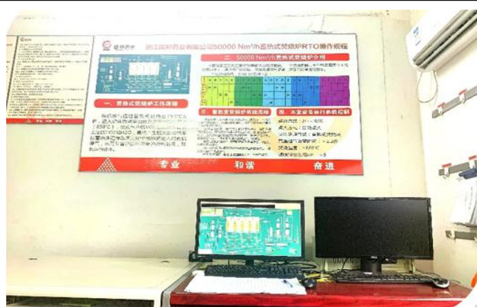
RTO: DCS 操作室
