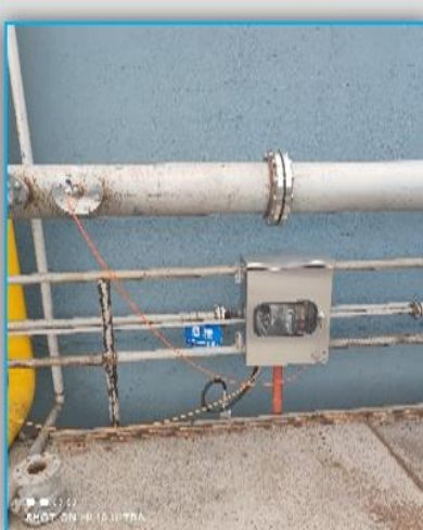
废气总管浓度检测仪
