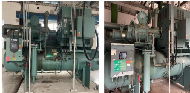
冷冻机组现场照片
