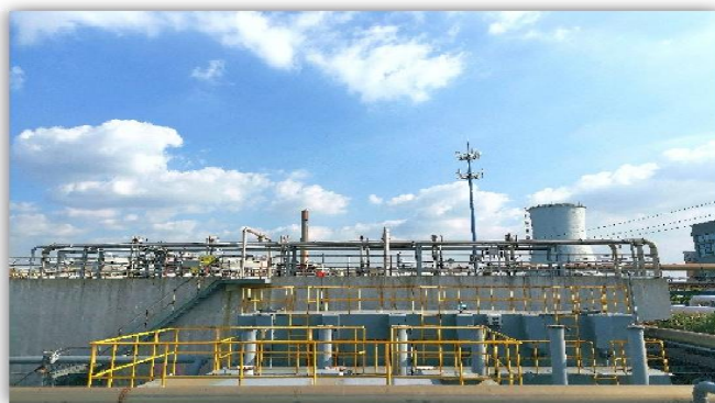
BAF 工艺处理废水
